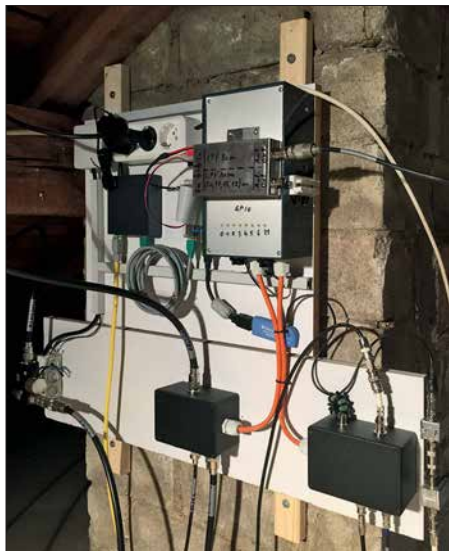
Bild 1: Der abgesetzte Steuerrechner samt Peripherie befindet sich auf dem Dachboden; Raspberry Pi, LAN-Switch, Tiefpassfilter für WSPR, Antennenrelais, DVB-T-Stick und Stromversorgung sind auf einer Montageplatte untergebracht.
