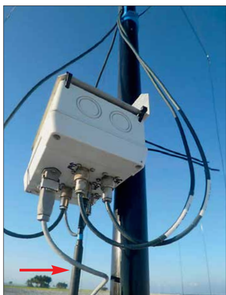
Bild 42: Fertig angeschlossene VDA-Umschaltbox; gut erkennbar sind das ins Shack führende Koaxial- sowie das Steuerkabel.
