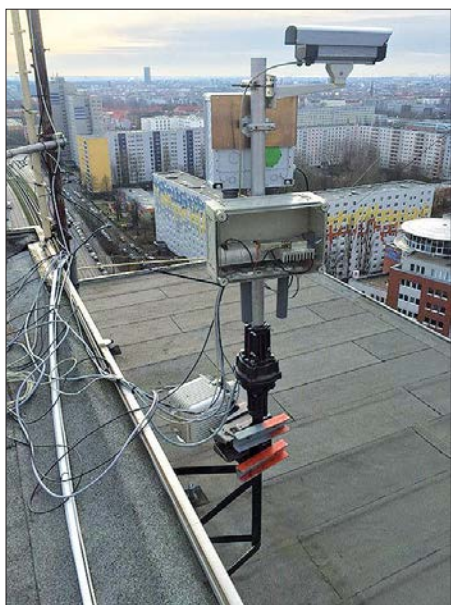
Die Outdoor-Unit von DB0KK: im Vordergrund die 24-GHz-Bake, darüber die 47-GHz-Bake und eine LAN-Kamera (damit DC7YS weiß, in welche Richtung die Bake steht); am Mastfuß ist der Rotor zu sehen.
