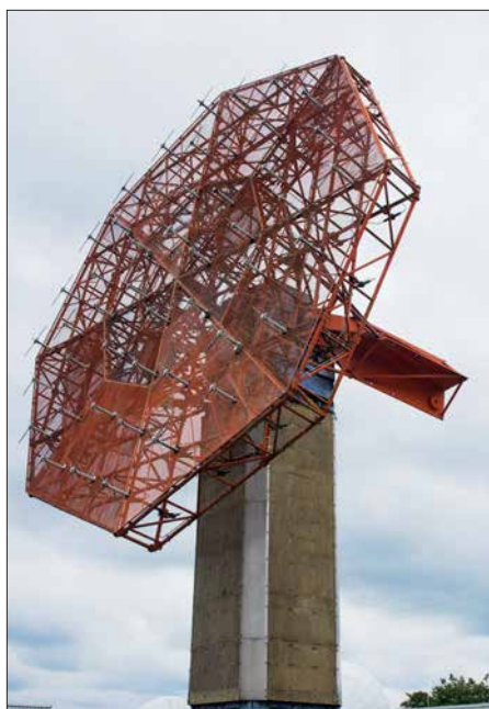
VHF-Antenne von 1968 – ein Dipol-Array vor einem roten Gitter-Reflektor
