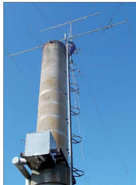
Die Antennen bei DA0WRTC (JO73CE): ganz oben die 10-Element-Yagi für 2 m (mit Heiko, DG1BHA, bei Montagearbeiten), darunter ein 6-Element-Beam für 10 m. Daneben sind die Relaisantenne für DB0UM und die DB0UM-Bakenantenne für 3 cm angebracht. Foto: DL3BQA
