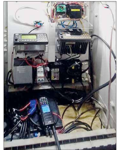
Blick in den Schaltschrank des MMDVM-Relais DB0USD mit den beiden verbauten Motorola-Funkgeräten GM1200E und GM1200 Foto: DO6UK
