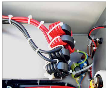
Bild 5: Die parallelgeschalteten Kabel auf der Sekundärseite des Schaltnetzteils erhöhen den wirksamen Leiterquerschnitt.
