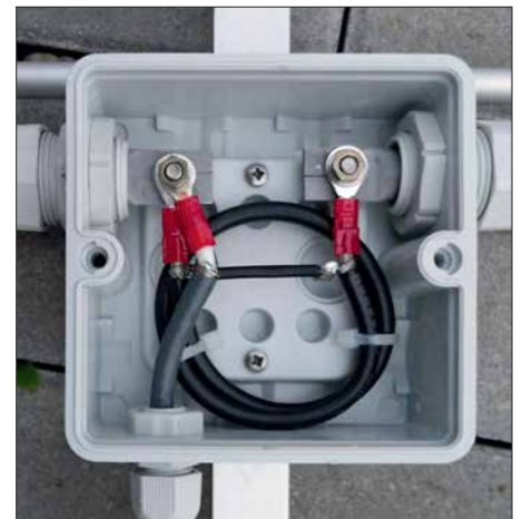
Bild 5: Anschlussdose mit aufgerollter Umwegleitung und Speisekabel
