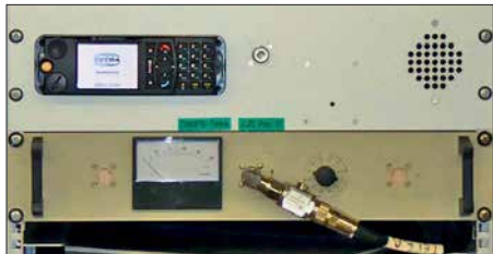
TETRA-Repeater bei DB0FS Foto: DL9DAK
