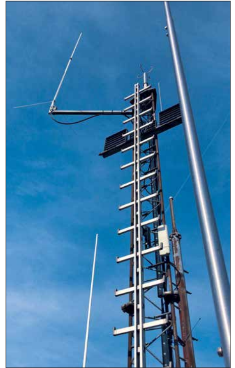
Koaxialantenne im Vordergrund und auf dem Antennenträger der Ausleger mit der X300-Antenne
